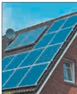
Fig. 38. Panouri solare pe acoperișul casei
