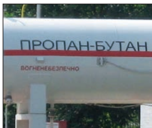
Fig. 21. Capacitate cu amestec propan-butan la stația de ali- mentare a auto- mobilelor
